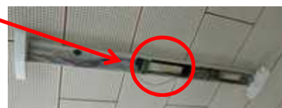
蛍光灯の安定器
